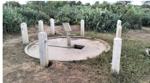
Un point d'eau abandonné et cassé. Le projet permettra de réparer ces infrastructures et de les entretenir pendant des années - financé par les frais d'utilisation et les revenus provenant de la vente de crédits de carbone.
